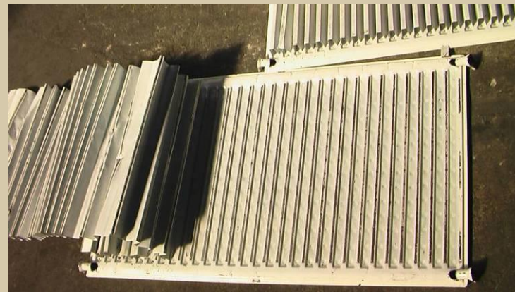
Kontrola zafarbenia pod konvektorom
